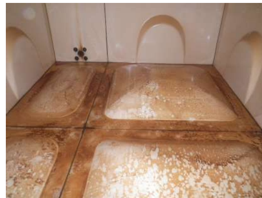
貯水槽内部の汚れ
